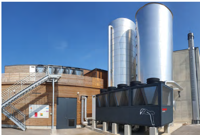
Im Biomasse-Heizwerk Neusiedl wird Windenergie mit Fernwärme gekoppelt.
